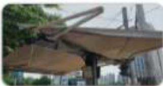
시설 파손(그늘막 등)
