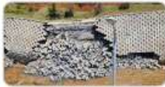
시설 파손(옹벽 붕괴, 포트홀 등)
