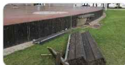
축제장 시설 파손
